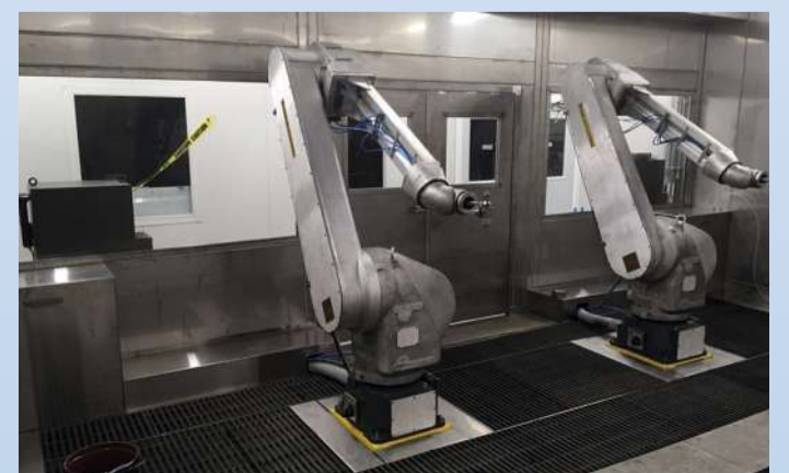
Lackieranlage mit Power&Free-Fördersystem
